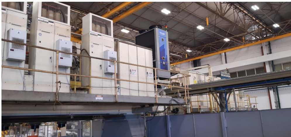
REFRISAT & SWEP equipamento instalado.
